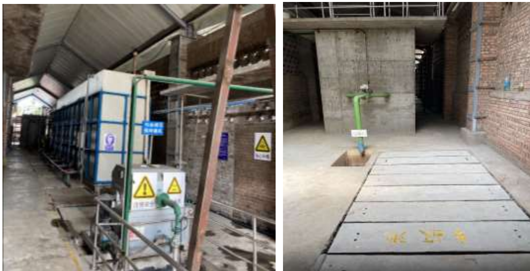
图 4-1 项目污水处理车间及事故池
